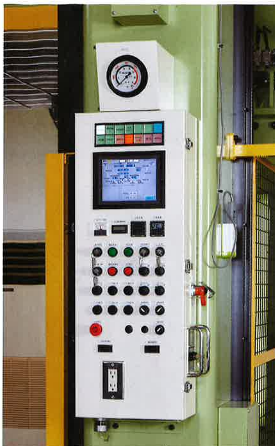
Control panel 操作盤
