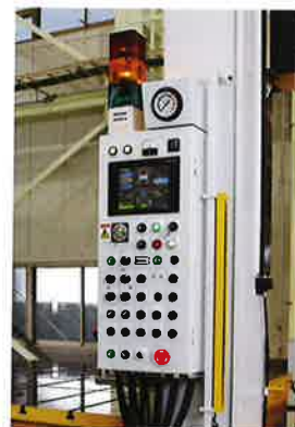
Control panel 操作盤
